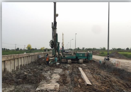
ดำเนินงานก่อสร้างเสาะเข้มในเวลากลางวัน (08.00-17.00 น.)
