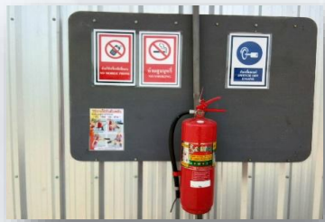
ติดตั้งถังดับเพลิงบริเวณบ้านพักคนงานก่อสร้าง
